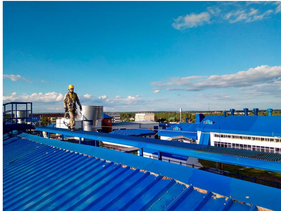
АО «Транснефть – Прикамье»: КРНУ
